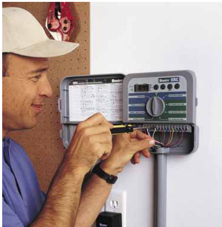
Használjunk színjelölt vagy számozott kábelereket. Mágnesszelepenként egy-egy érre és ezeken kívül további egy közös vezetékre van szükség. Ne feledjük el, hogy az esőérzékelő vezetékpárját is be kell kössük az automatikába.
